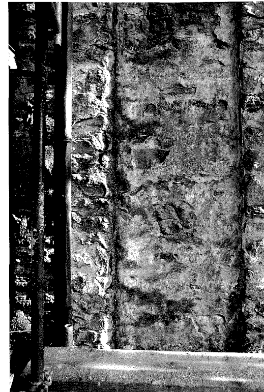
Clocher, façade nord, angle nord-ouest - Etat de conservation des enduits, des jointoiements et de l'appareil avant traitement - Mai 1994
