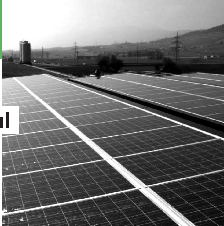
Une référence: le centre d'entretien autoroutier de Bursins est autonome en énergie. Cette réalisation a reçu le Prix solaire Suisse 2007
