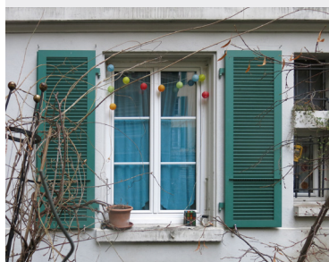
Fenêtres pvc doubles vitrages remplacées par fenêtre bois triples vitrages avec croissillons et grille hygroréglable
