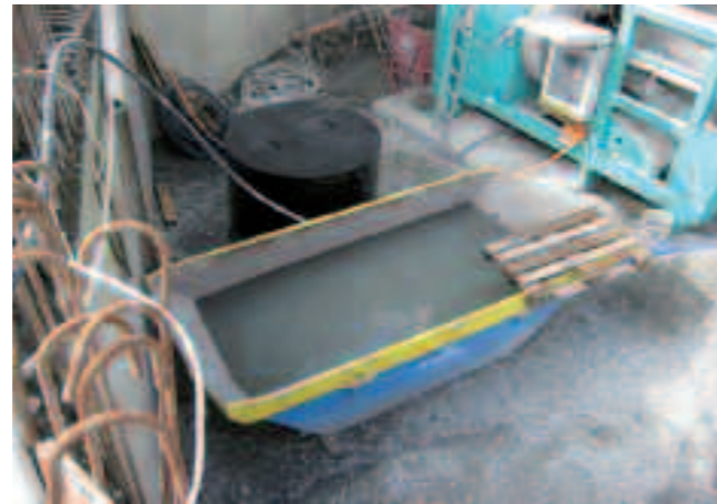
Exemple de traitement des eaux alcalines de chantier par décantation et neutralisation.
