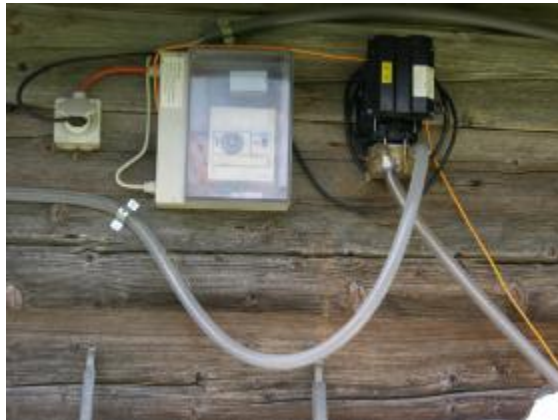
Photo 9 : Dispositif de pompage de « Pra Cornet » avec système de régulation des injections
