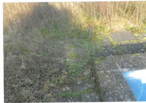
Etat des dalles
