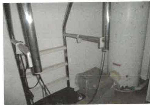
Matériel pour la piscine
