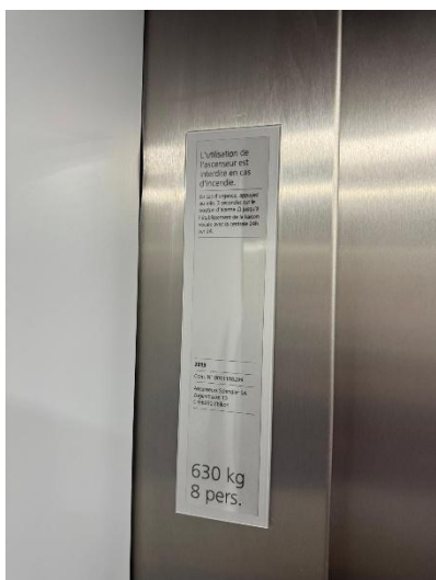
Ascenseur accès handicapé
