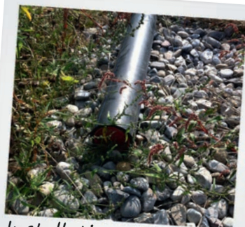
Installation provisoire d'infiltration
