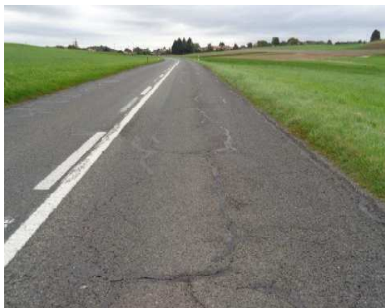
Figure 3 : Fissures dans le revêtement (voie direction Bottens)
