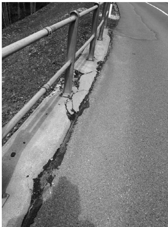
Photo 4 : longrines fortement dégradées sur mur en maçonnerie
