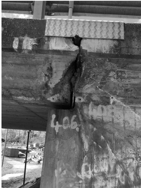
Photo 8 : détails des dégâts culée
