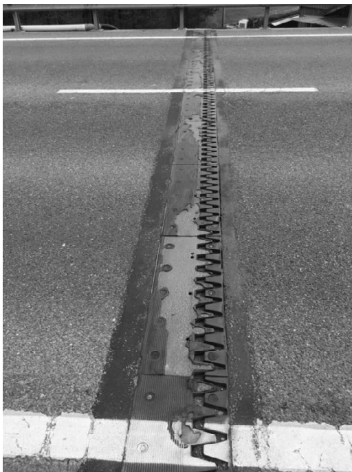
Photo 14 : Joint de chaussée dégradé
