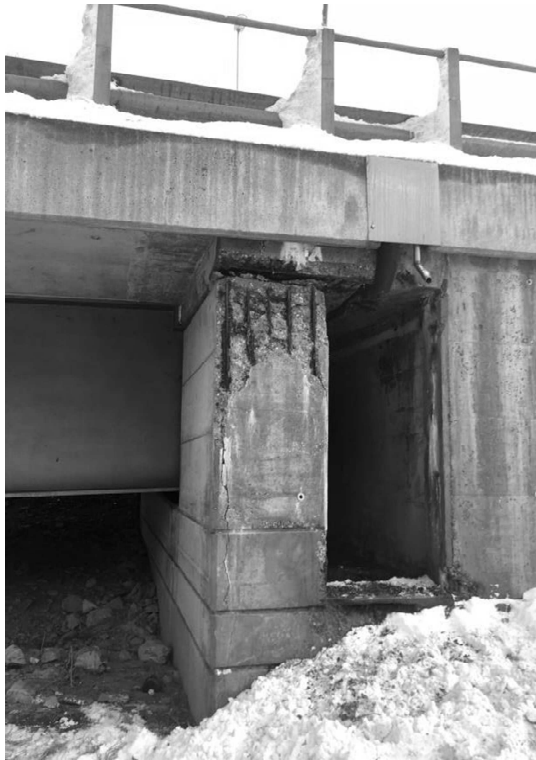
Photo 10 : détails des dégâts culée
