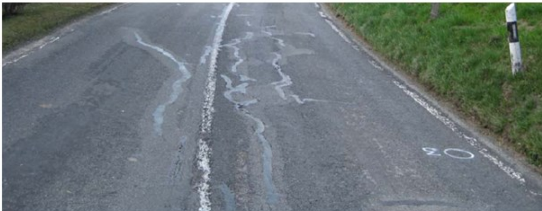
Fissures et absence d'accotement
