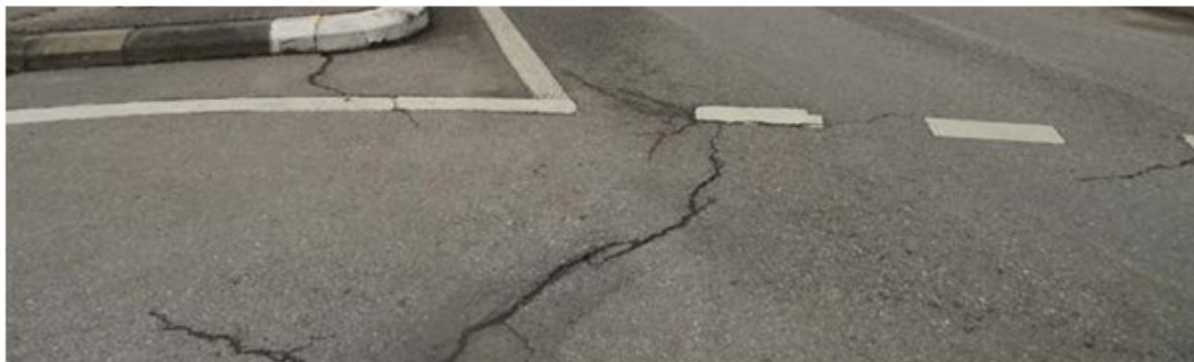
Fissures dans le giratoire
