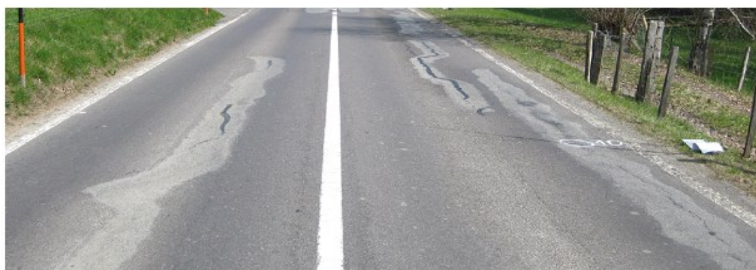
Fissures et affaissement bord de chaussée droit
