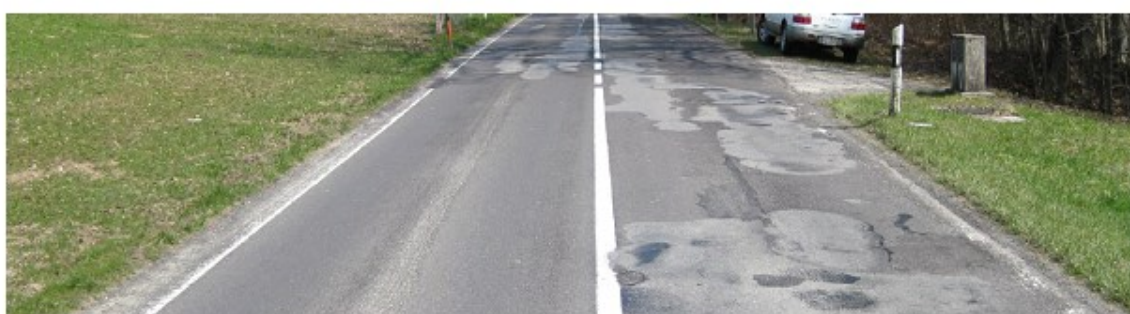
Usure du revêtement
