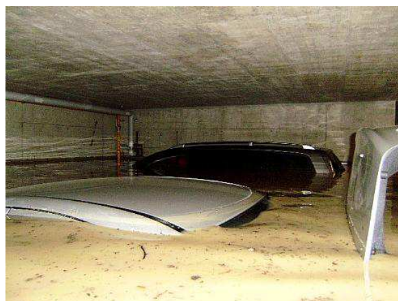
Parking inondé – 26 & 27 juillet 2008
