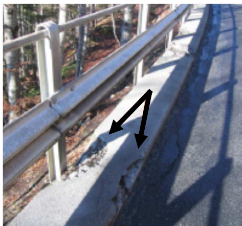
Figure 5 : Exemple de dégradation de bordures
