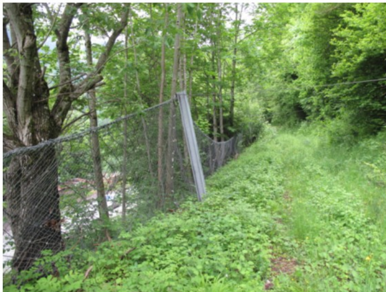
Image 6 : exemple de filets de protection
