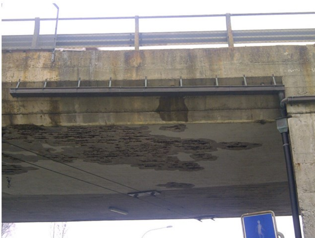
Vue de la face inférieure du tablier, avec barres d'armature apparentes et corrodées
