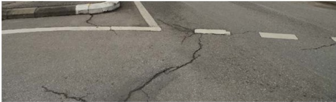
Fissures dans le giratoire
