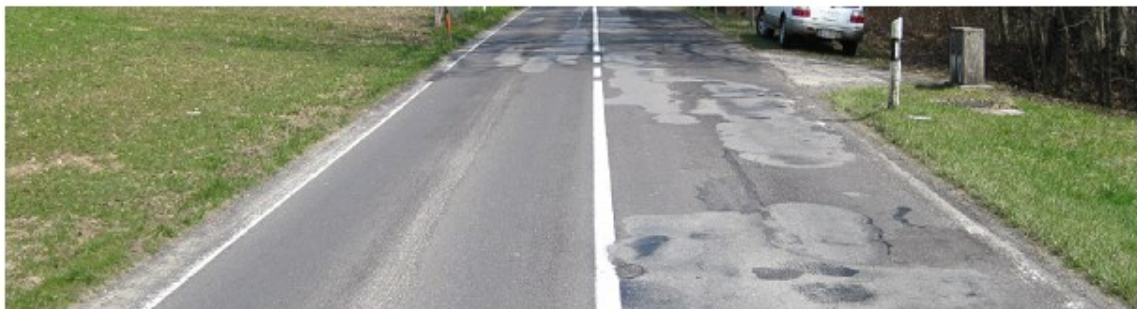
Usure du revêtement
