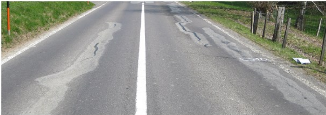
Fissures et affaissement bord de chaussée droit
