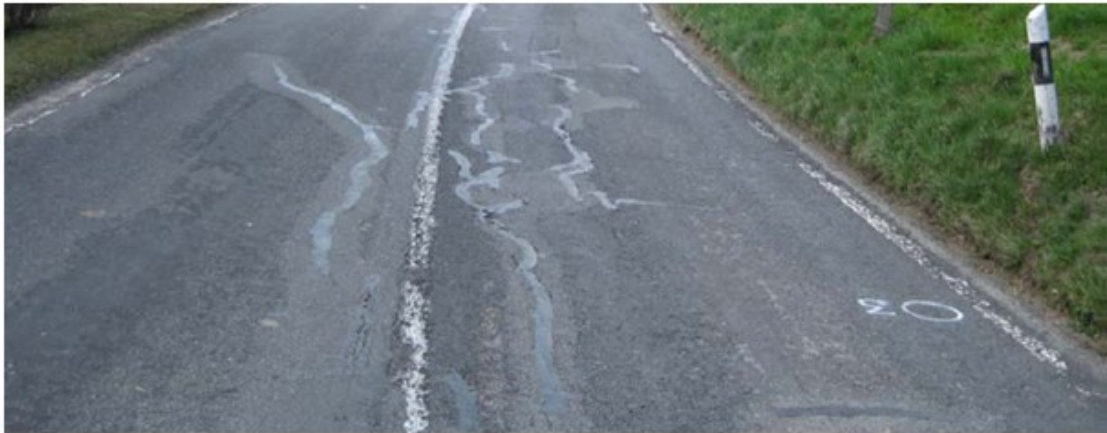
Fissures et absence d'accotement
