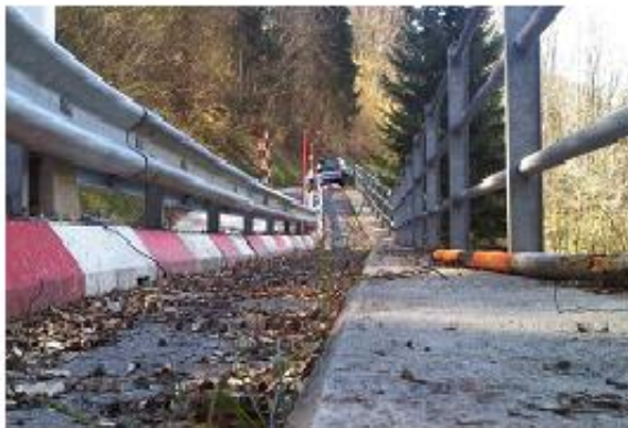
Photo 3: Vue générale du tassement de l'ouvrage
