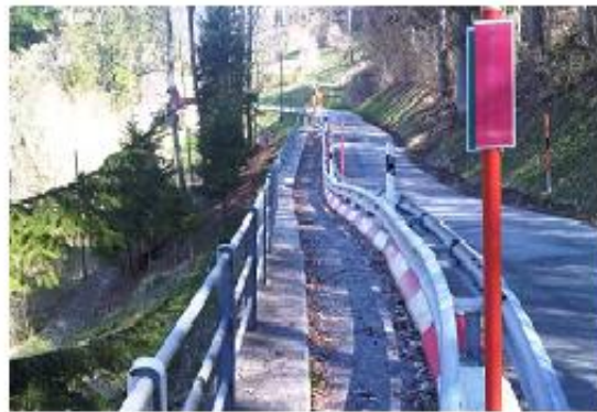
Photo 4: Vue générale du tassement de l'ouvrage
