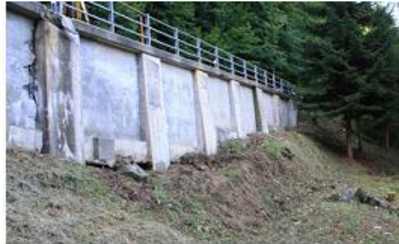
Photo 2 : vue côté La Forclaz avec vides sous l'ouvrage
