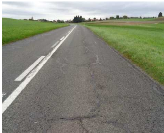
Figure 3 : Fissures dans le revêtement (voie direction Bottens)
