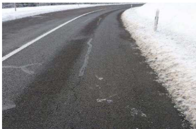
Figure 2 : Fissures dans le revêtement et affaissement de bord de chaussée droit (voie direction Cugy)
