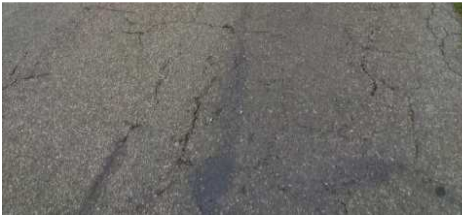
Figure 4 : Fissures dans le revêtement (voie direction Cugy)
