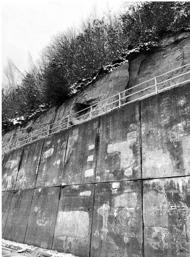
Figure 13 : RC 701 éboulement d'un bloc et présence d'écailles instables le 27 janvier 2021
