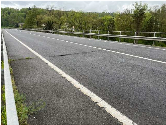
Image 1 : Glissières et joint de chaussée « Berne »
