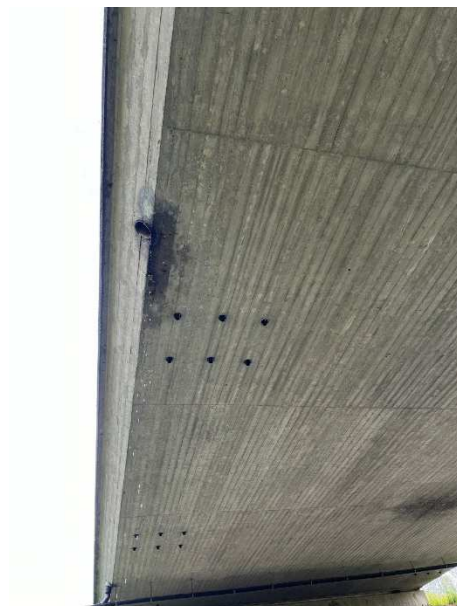
Image 6 : Evacuation des eaux de chaussée
