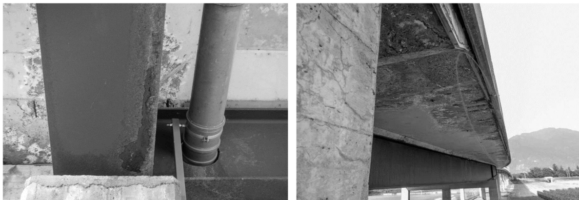
Corrosion sur une des poutres métalliques (à gauche) – Corrosion en sous face du tablier (à droite)
