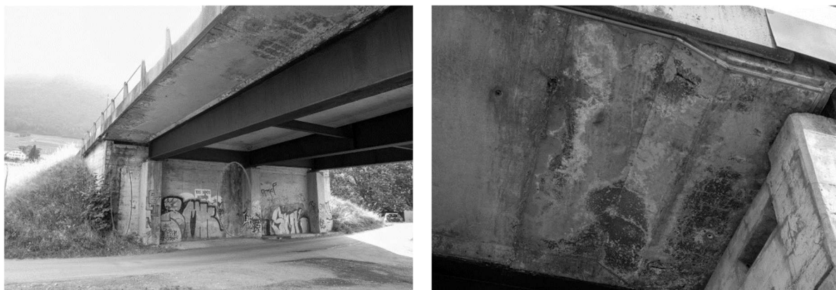
Dégradations multiples culée côté Yvorne (à gauche) – Zones humides culée côté Aigle (à droite)
