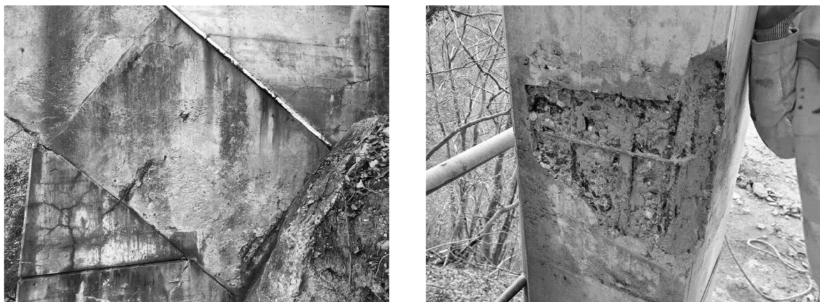
Figure 5. Fissuration et béton de mauvaise qualité en pied de l'arc (à gauche) – Eclat de béton d'un pilier (à droite)
