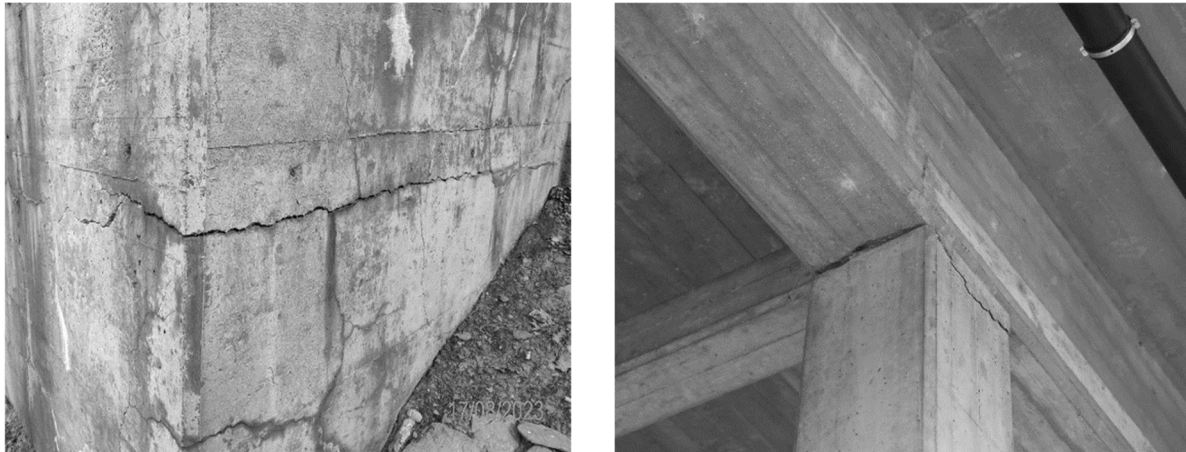
Figure 6. Béton de mauvaise qualité sur un mur (à gauche) – Fissure ouverte en tête de pilier (à droite)
