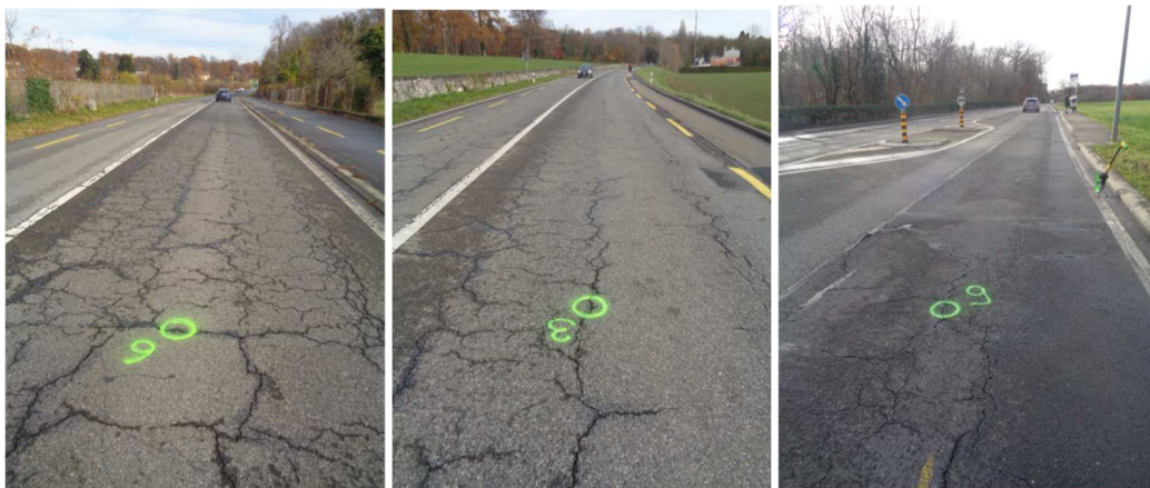
Fig. 5 – État de la chaussée (fissuration diverse, orniérage et faïençage)
