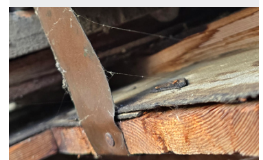
Attention: Sous-couverture en carton bitumé et plaques GEA à enlever, car totalement étanches à la vapeur
