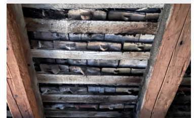
Toiture existante sans contre-lattage. Impossible d'isoler en l'état par l'intérieur, attention aux problèmes de ventilation
