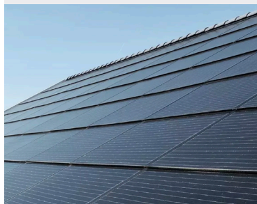
Exemple d'intégration de panneaux solaires photovoltaïques en toiture Référence voir fiche méthodologie
