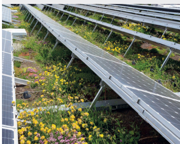
Toiture plate végétalisée avec des panneaux photovoltaïques Référence voir fiche méthodologie
