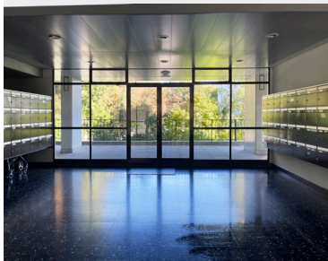
Préservation des menuiseries d'origine. Espace actuellement chauffé.
