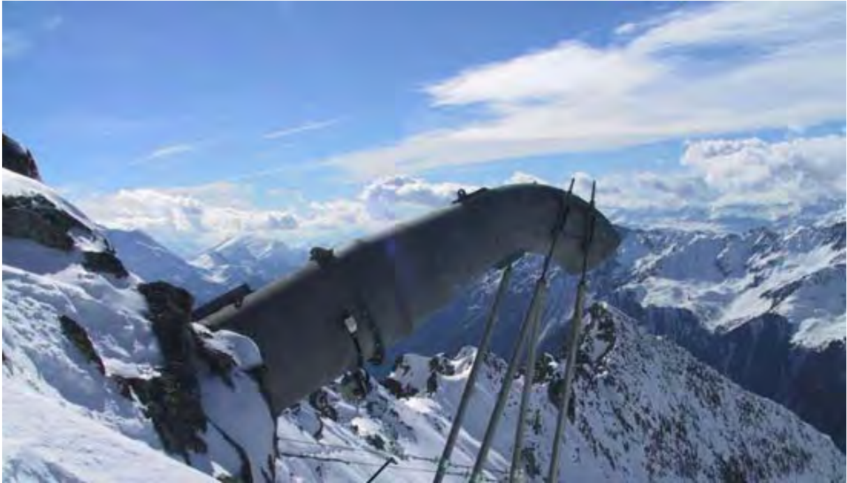
Illustration 13 : installation fixe de déclenchement des avalanches par explosion de gaz (dispositif « gazex »), © TAS.
