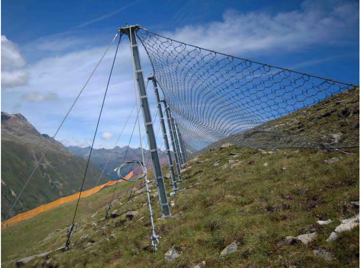
Illustration 12 : les paravalanches peuvent constituer des atteintes paysagères importantes. On ne devrait pas aménager de pistes nécessitant la construction de paravalanches.
