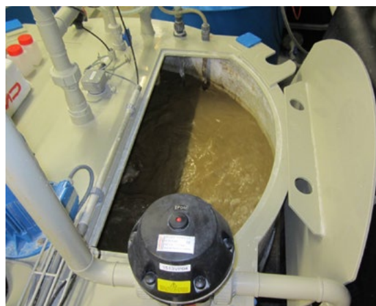
Installation de prétraitement d'eaux industrielles
