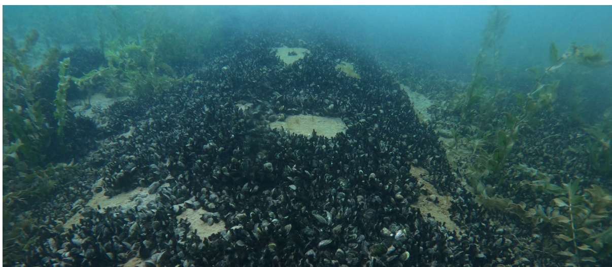
Colonisation de la partie supérieure de la conduite d'eau brute de l'usine de Lutry par les moules quagga. Ville de Lausanne, mai 2023
