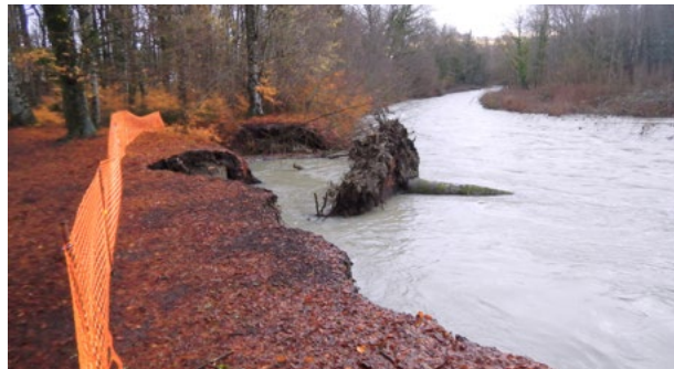
Niche d'érosion sur l'Aubonne
