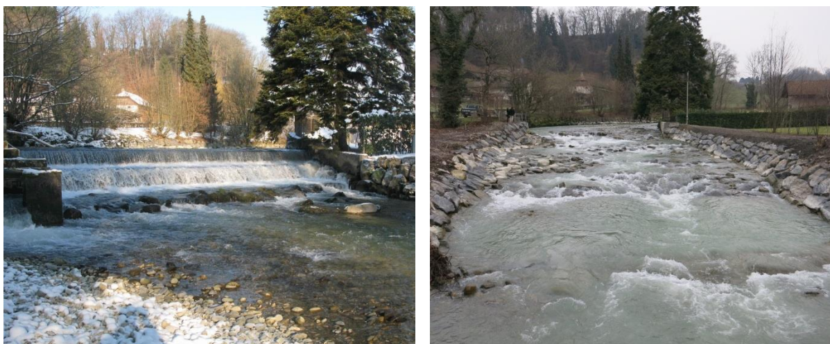
Figure 5 Exemple de l'obstacle avant (à gauche, en 2012) et après son assainissement (à droite en 2014). L'Aubonne (obstacle n° 50, concession17-507, Poudredrie SA). Source : DGE-EAU, 2014.
