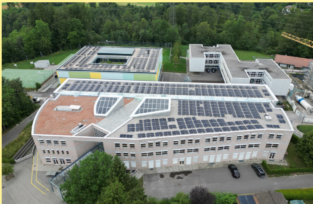
Installations solaires photovoltaïques du bâtiment neuf (A) et existant (F) du complexe scolaire
