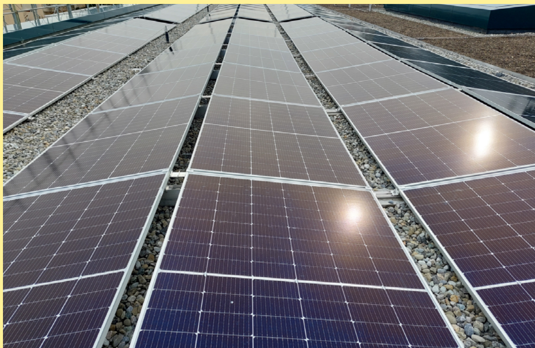
Installation solaire photovoltaïque du bâtiment D du complexe scolaire de Bois-Murat
