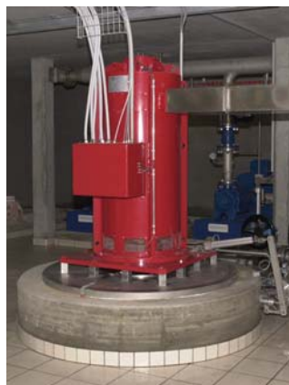
Petite centrale sur l'eau potable à Ollon ©MHyLab
