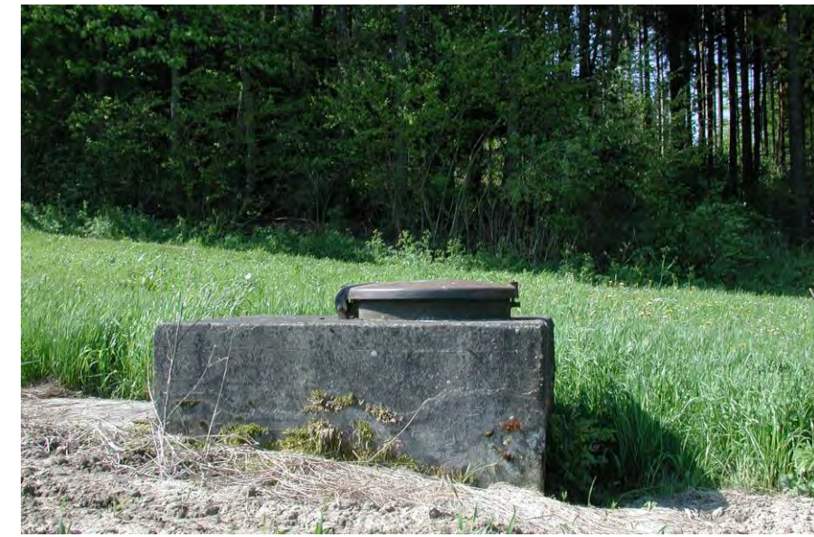
Chambre de captage de source à Thierrens, 2005
