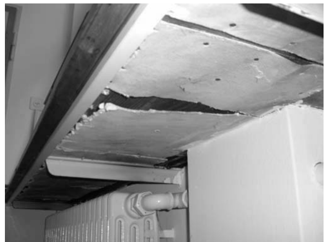
Carton d'amiante accessible fixé sous un appui de fenêtre, photo Laboratoire cantonal de Bâle-Ville
