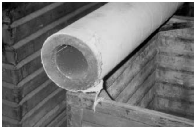
Calorifugeage contenant de l'amiante, photo IST
