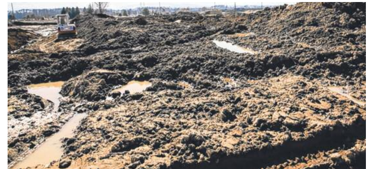
Terrassement en conditions humides pour déverser des matériaux d'excavation de chantier dans un parcelle agricole. Les dégâts sont tels que les atteintes à la fertilité et au potentiel de production sont définitives.
