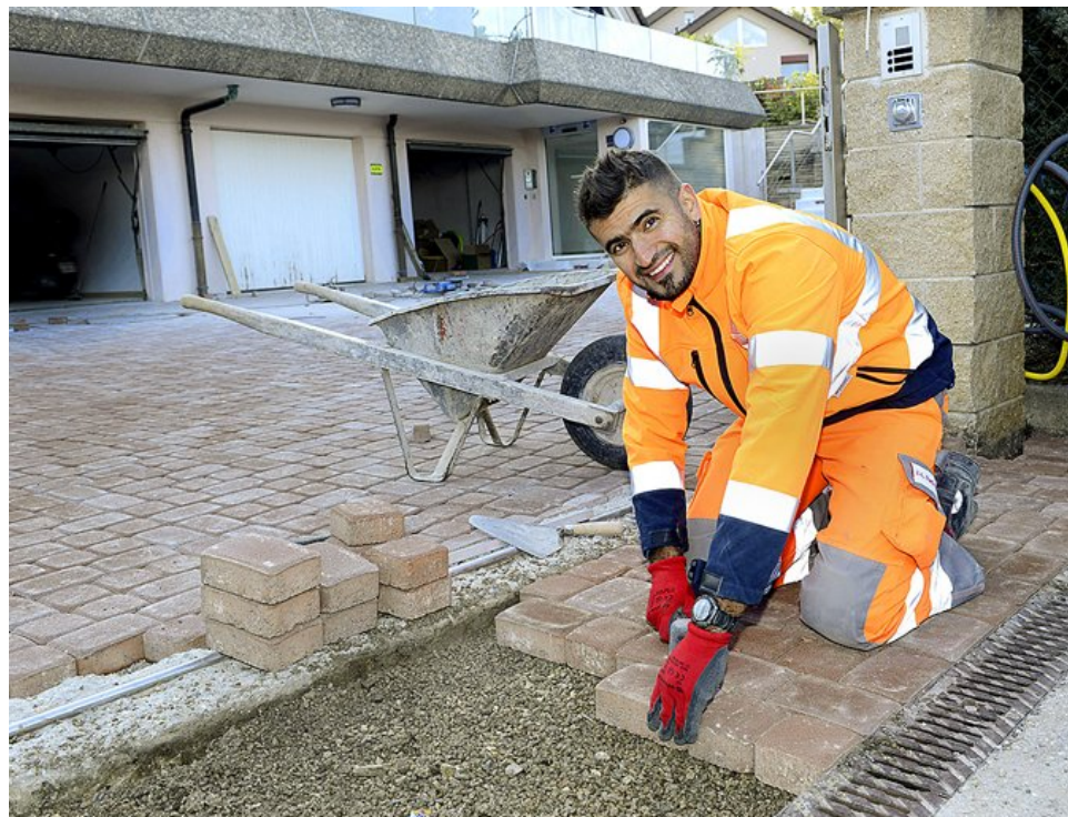
Arrivé du Portugal en Suisse en 2008, Ivo Ribeiro Mendes a depuis lors obtenu trois certifications professionnelles dans la construction: «Cela m'a donné confiance en moi.»
