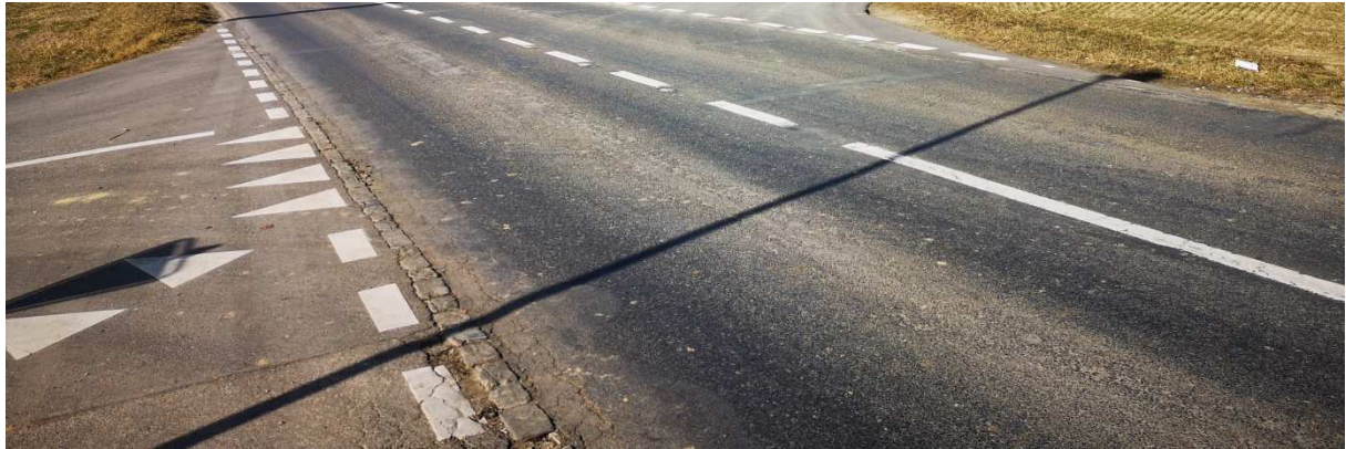
Figure 2 : Usure du revêtement
