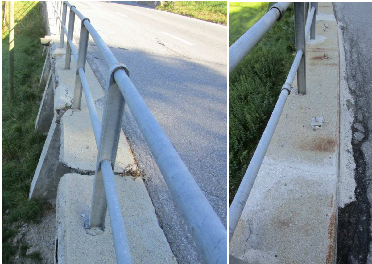
Fig. 3 et 4 Murs de soutènement fissurés et éclatement du béton d'enrobage
