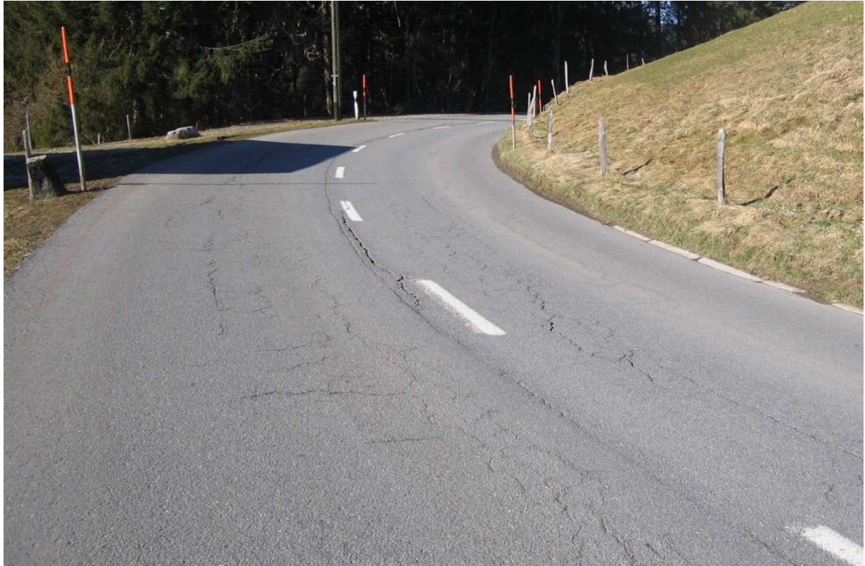
Fig. 2 Enrobé fissuré et manque de visibilité
