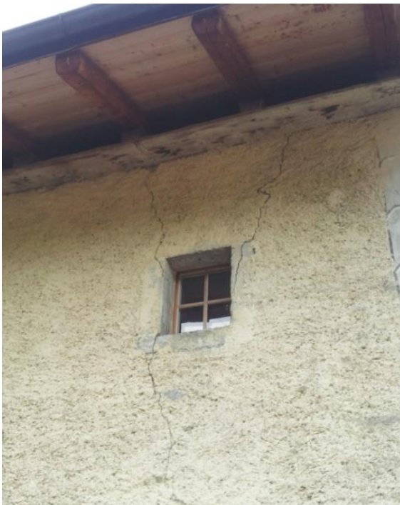
Figure 8. Bâtiment légèrement fissuré. Présence de doline non avérée, mais géologie favorable à l'apparition d'un phénomène d'effondrement par dissolution du gypse (Panex, UDN 2012).
