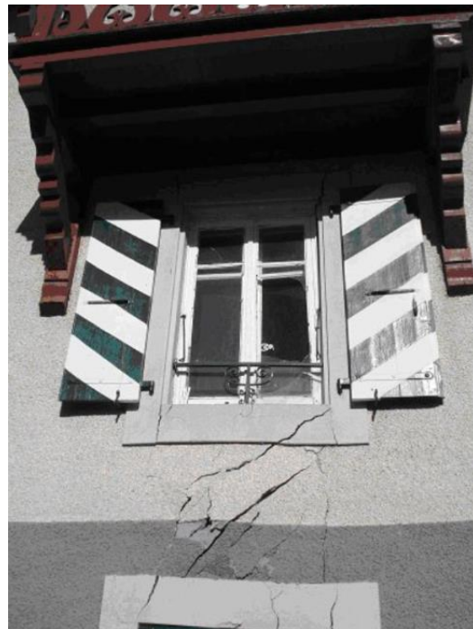
Figure 9. Bâtiment fissuré avec tassement différentiel à cause de la présence d'une doline sous-jacente (Huemoz, UDN 2015).
